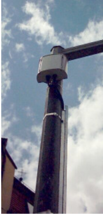
Bismarckplatz, Mikrozele am Kameramast beim Treppenabgang zur Tiefgarage
